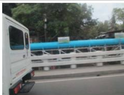
ダバオ市内水道管
