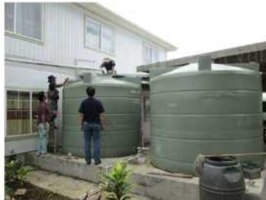
写真.天水タンク（FRP製）
